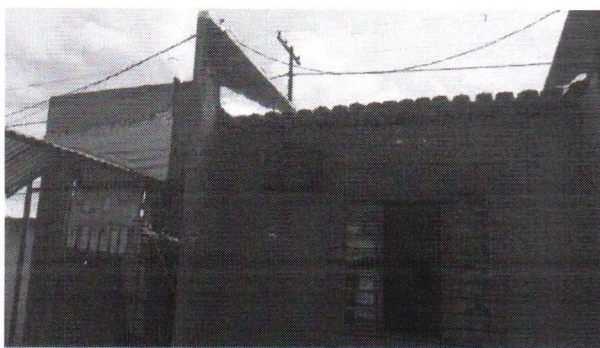
Figura 15: Espaço entre onde deve ser construído uma cobertura para passagem que é dificultada quando chove.
