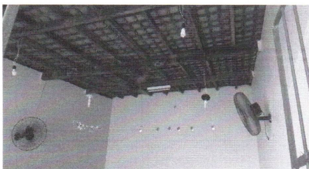
Figura 17: Sala de aula sem forro pé
