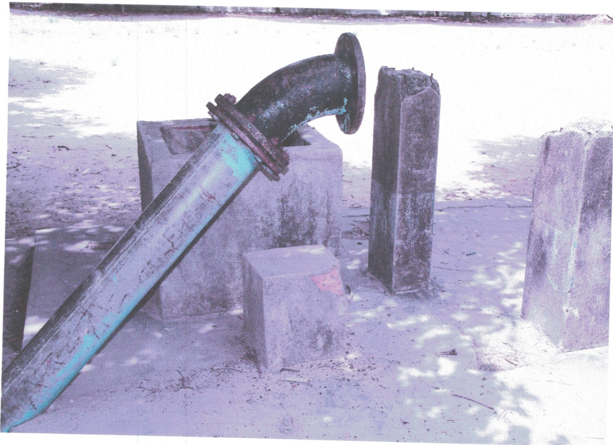
FIGURA 03: DEFEITO DA TUBULAÇÃO DE BOMBA DE ÁGUA
