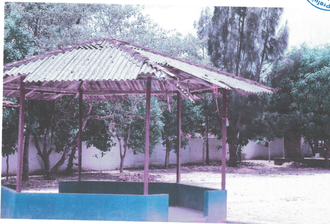
FIGURA 02: ESTRUTURA COM RISCO DE DESABAMENTO
