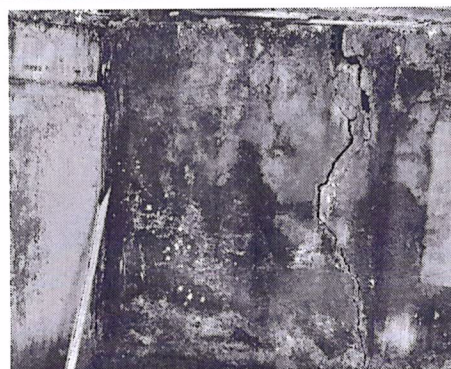
Foto 05- rachadura no muro lateral.
