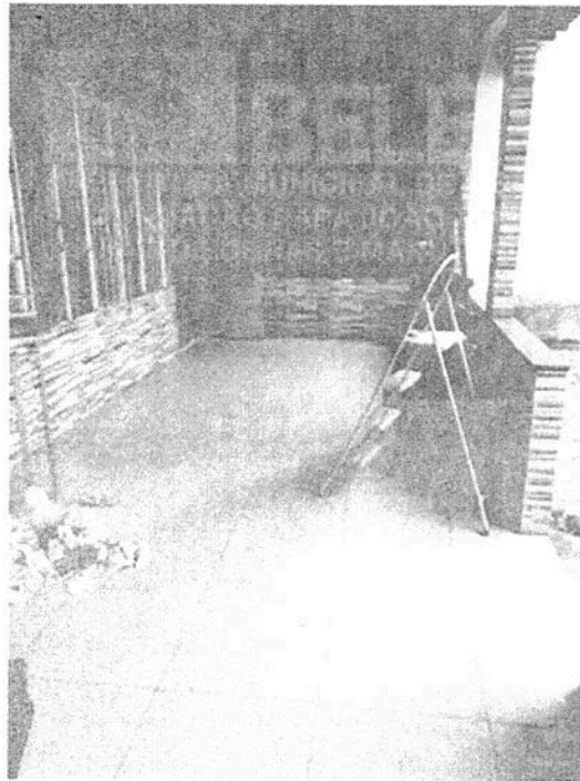
Foto 14: Entrada da casa ainda estava sendo limpa a, pois a pintura da casa feita pelo proprietário, no ato do recebimento do imóvel.
