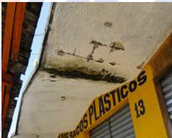
FOTO 02 – PONTO DE INFILTRAÇÃO
