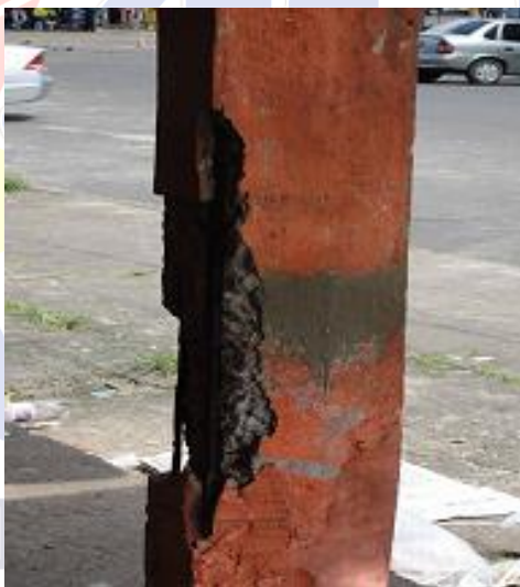
FOTO 01 – ARMADURA EXPOSTA - PILAR EXTERNO
