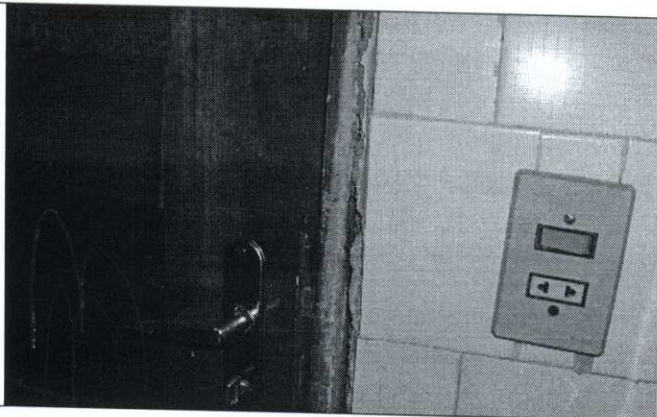
Imagem 04: Vista porta danificada;
