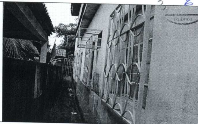
Imagem 02: Área externa fachada lateral (pintura deteriorada);
