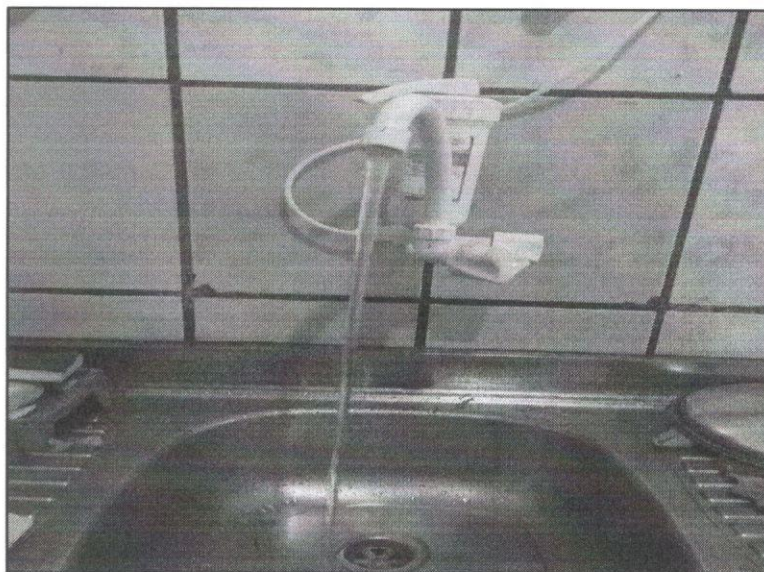
Figura 5 - Ponto de água fria da cozinha.
