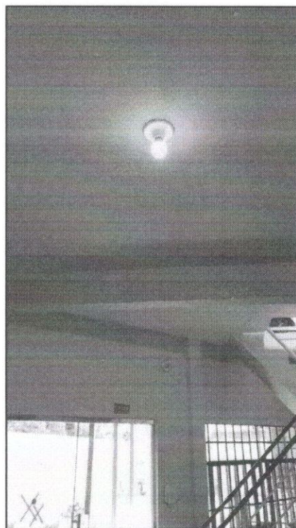
Figura 4: Ponto de energia
