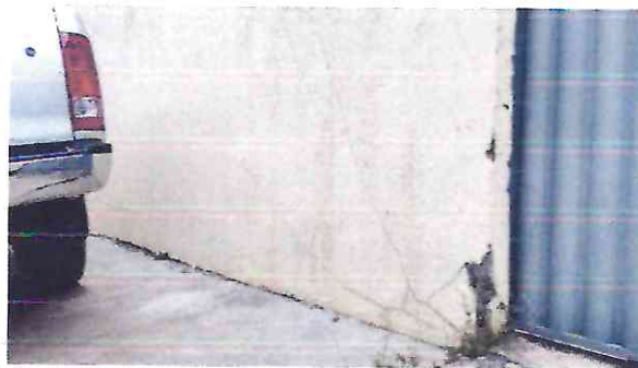
Foto 02: Vista aproximada do dano ao muro
