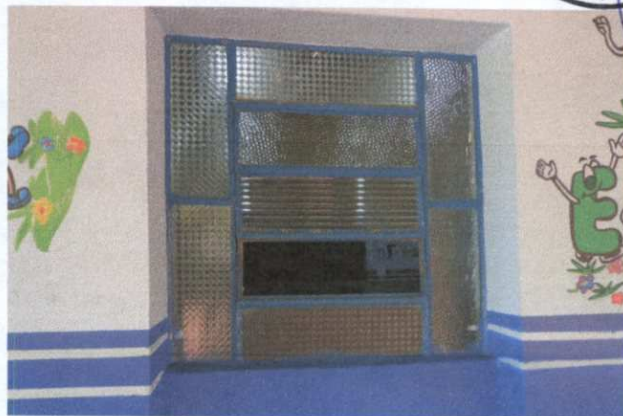
Imagem 02: Janela sem o vidro;
