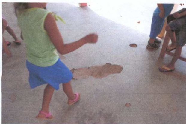
Imagem 03: Piso cimentado área livre danificado;
