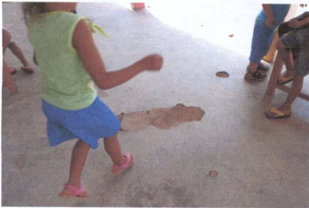
Imagem 03: Piso cimentado área livre danificado;
