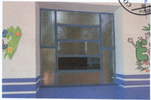
Imagem 02: Janela sem o vidro;
