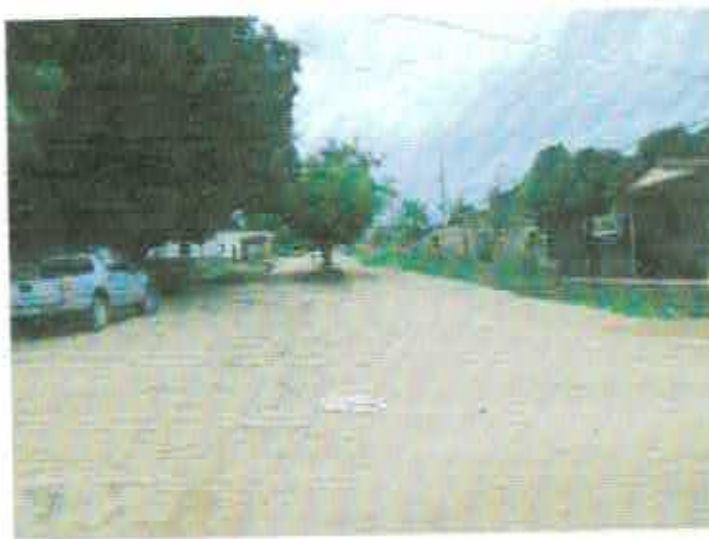
IMAGEM MOSTRA UM AOUTA SITUAÇÃO DA VIA(RUA ANCHIETA) DATA: 05/02/2014
