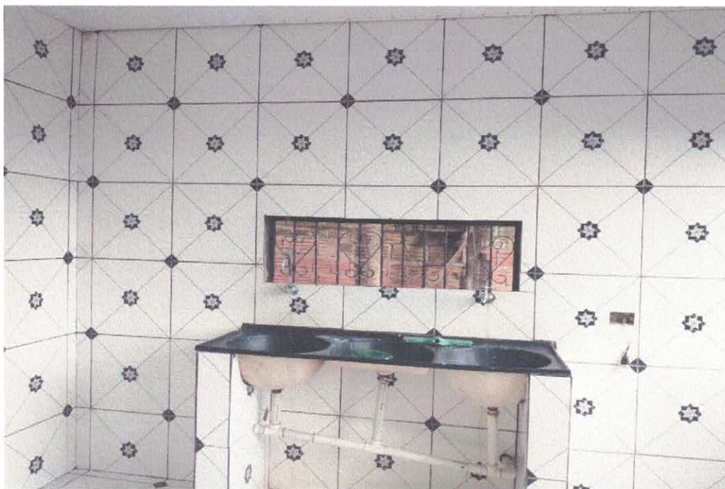
Imagem 11 – Área de serviço
