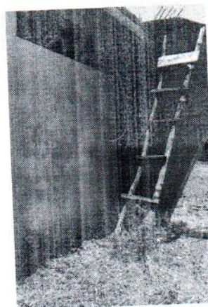
Foto 08 – Pilar “P1” não amarrado
