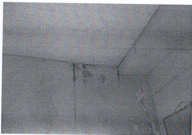
FORRO EM PVC/ COM PRESENÇA DE UMIDADE
