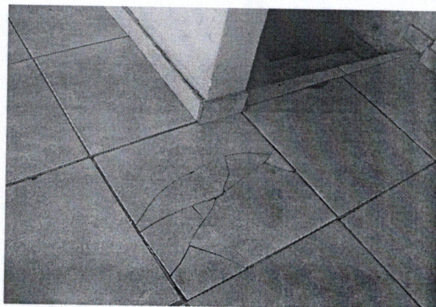
PISO CERÂMICO DETERIORADO
