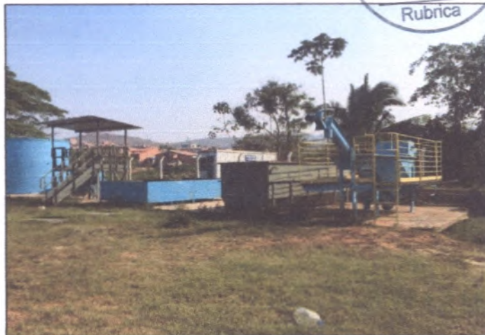
Foto 02 - Filtros, caixa de gordura e desarenador
