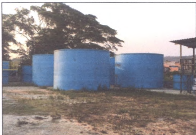
Foto 03 - Reatores biológicos aerados
