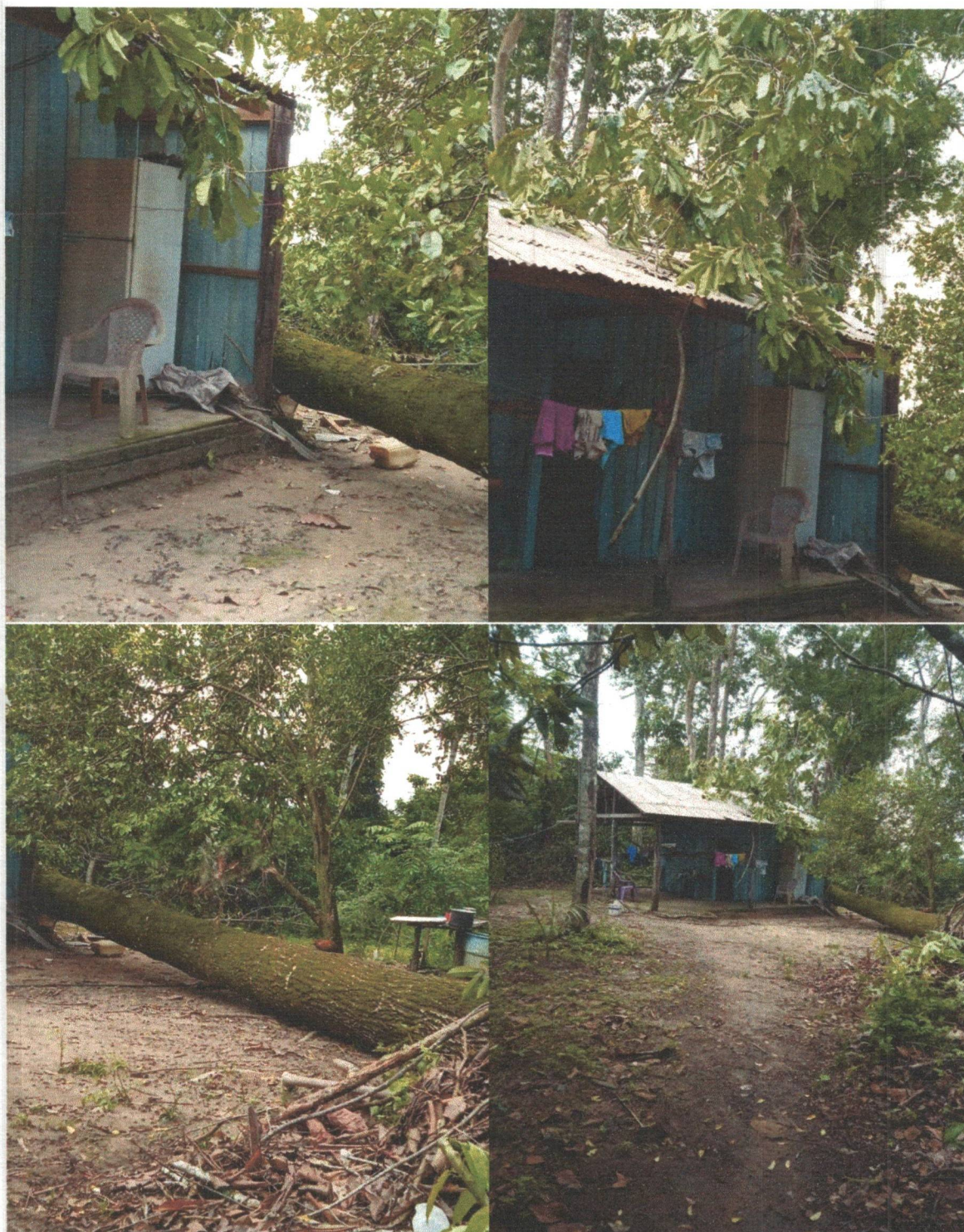
Localização: -2.783606, -49.664210. Queda de castanheira danificado parte de uma residência.
