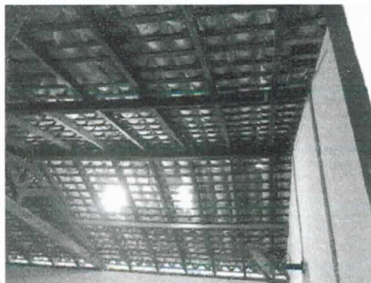
sem forro nas salas
