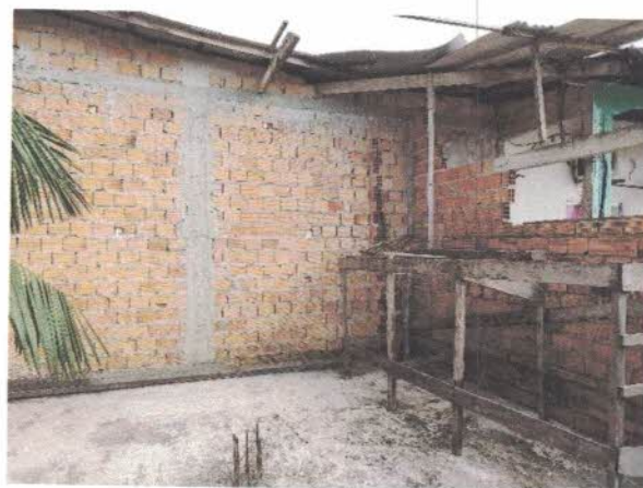
Figura 9 - Sala de Aula Inacabada
