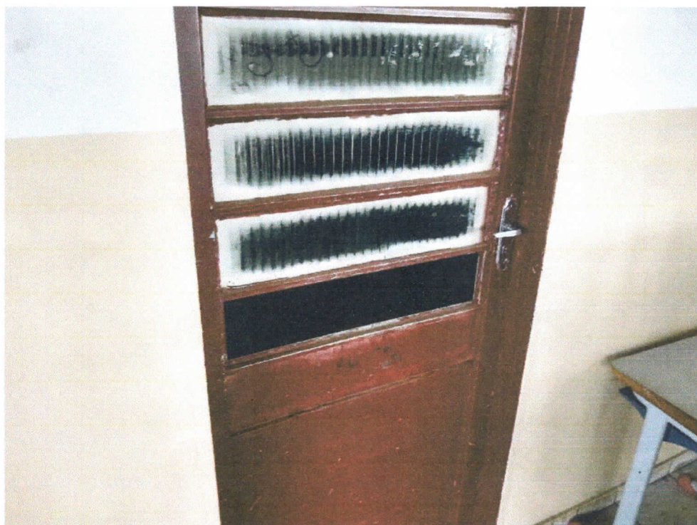
Foto 11 – Porta com necessidade de reposição de vidro
