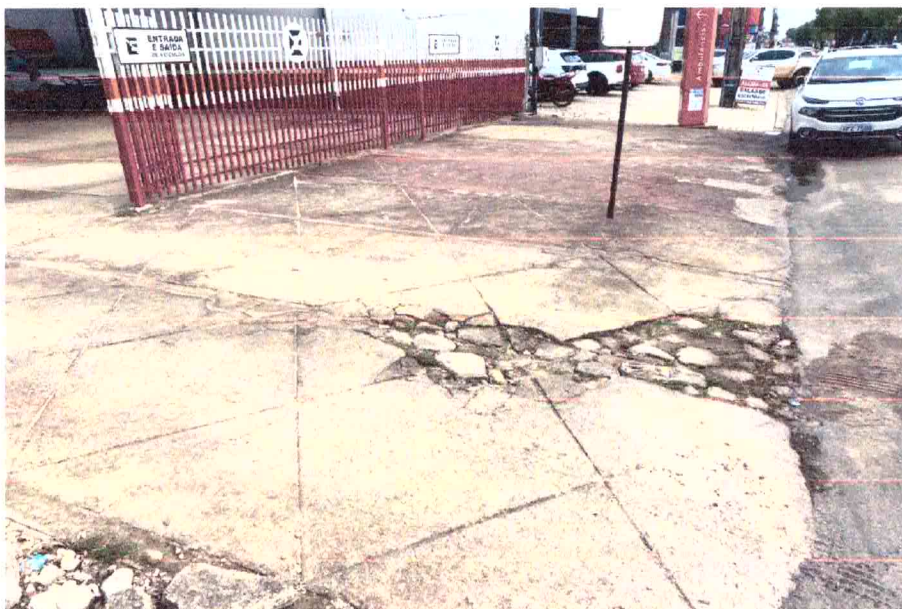
Figura 04 – Calçada com necessidade de reparos
