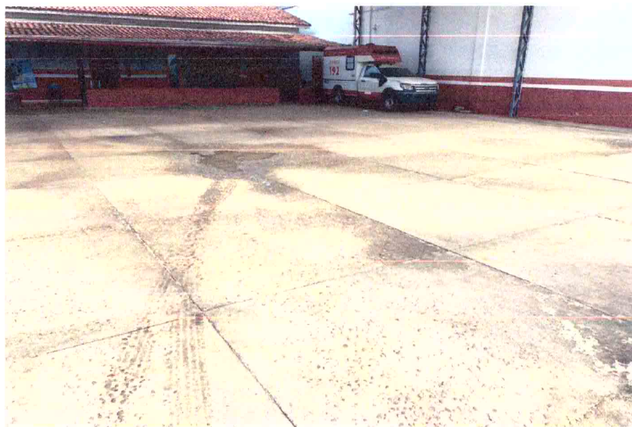
Figura 06 – Desnível de pisos.
