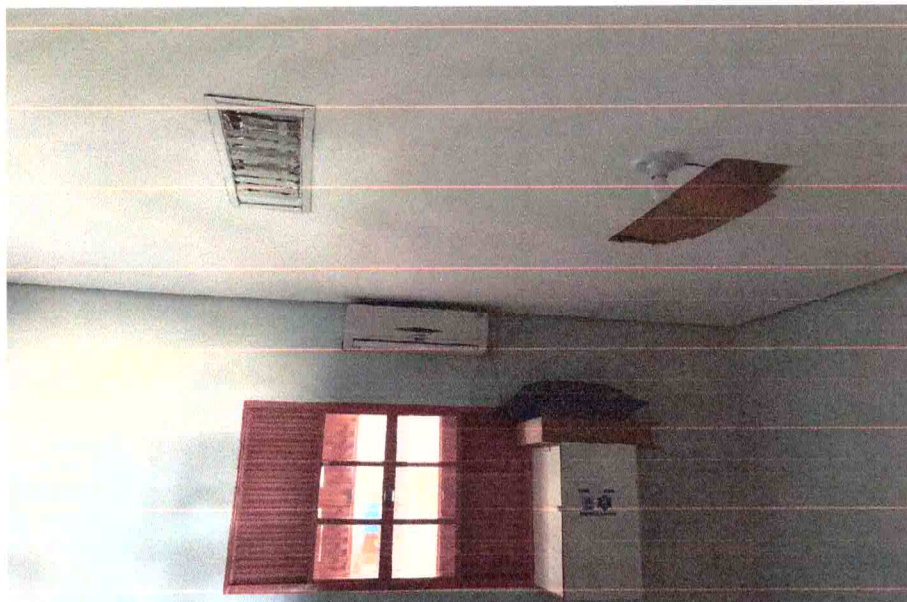
Figura 12 – Forro com necessidade de Reparos
