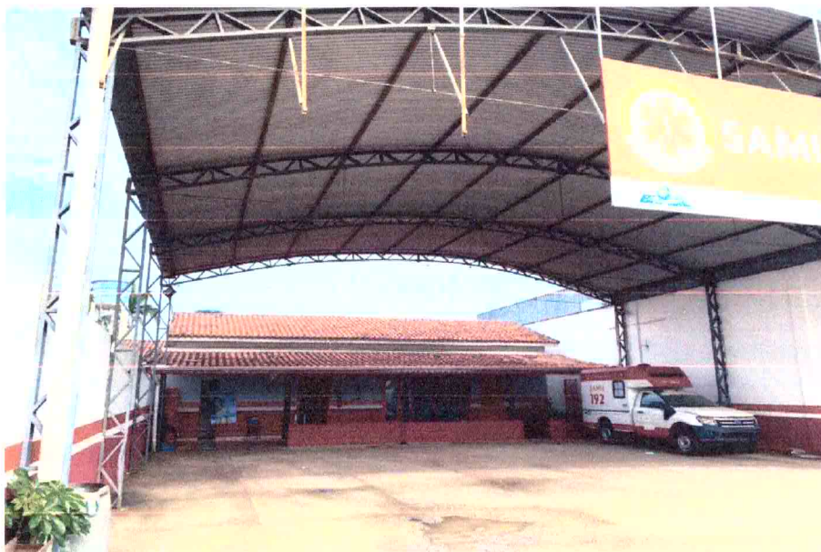
Figura 05 – Acessos Internos com necessidade de Reparos
