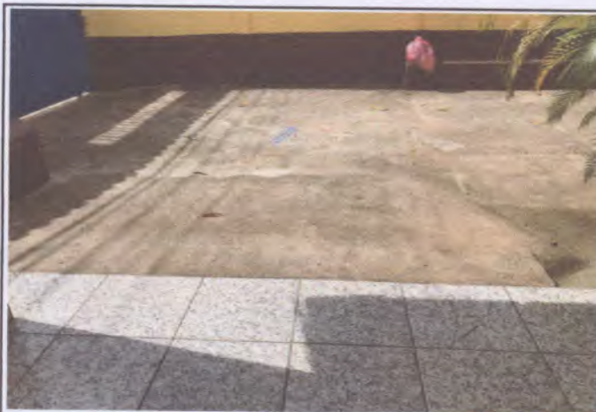
Foto 06: Rampa acessível que permite o acesso de cadeirantes ao interior do imóvel.
