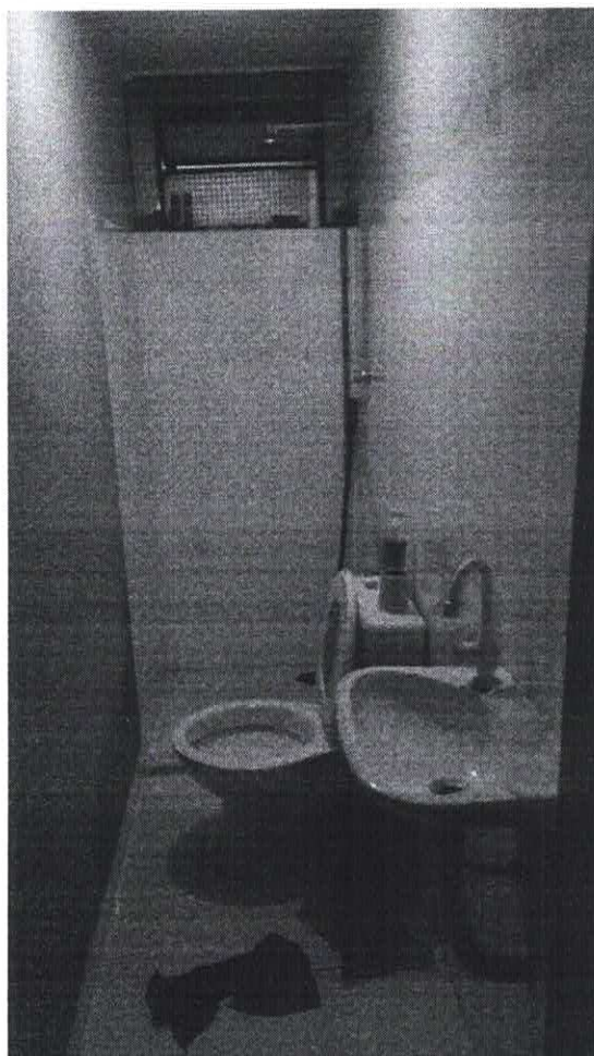
Figura 10 - Instalações hidráulicas do banheiro
