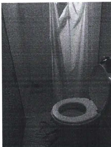
Figura 9 -Instalações hidráulicas do banheiro
