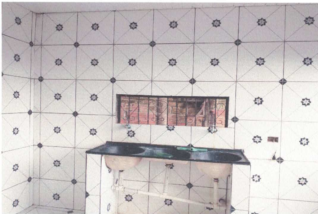
Imagem 11 – Área de serviço
