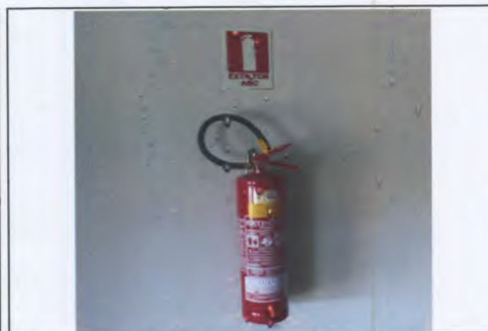
Foto 05: Extintor com identificação instalado
