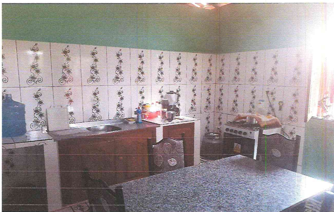
FOTO 04: REVESTIMENTO CERÂMICO DE PAREDE
