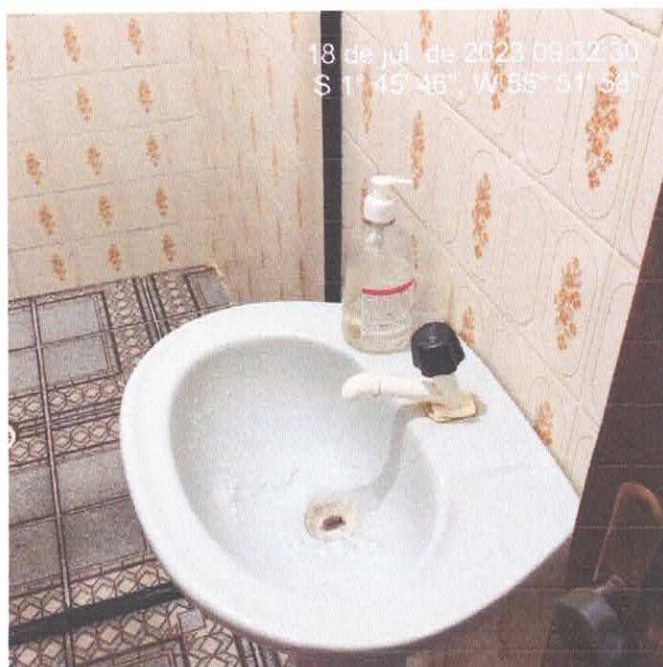
Figura 7 – pontos de água fria.
