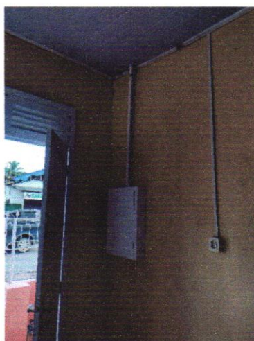
Foto 15 – Caixa de distribuição elétrica.
