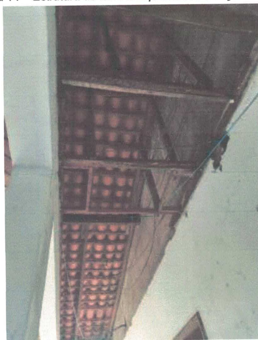
Figura 14 – Estrutura do forro comprometido e fiação exposta.
