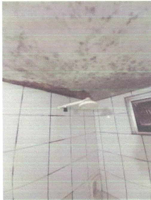
Figura 6 - Banheiro 02 identificação da infiltração e mofo.
