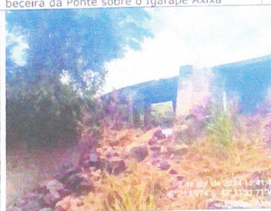
Imagem 03 – Ponte de madeira sobre o Igarapé Axixá, com cerca de 24 metros de extensão com estrutura de base parcialmente comprometida pela força de corrente de água pluvial, principal via de escoamento de produtos alimentícios produzidos na Zona Rural.
