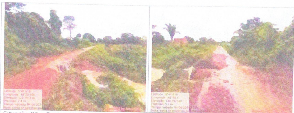
Situação 03 – Bueiro danificado e margem lateral da Estrada Vicinal Viração parcialmente erodida pela força de corrente de água pluvial, via de acesso para a rota escolar e escoamento da produção de leite, gado, e produtos alimentícios produzidos na Zona Rural, causando sérias dificuldades de tráfego a população local.
