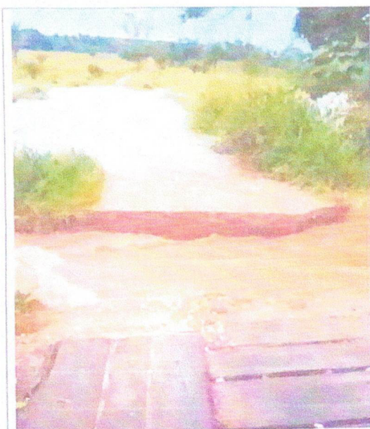
Imagem 01 – No momento do evento, com comprometimento da via de acesso com interrupção total da Vicinal de que interliga a zona urbana a zona rural de Vila Santa Isabel, com carreamento do aterramento de cabeceira da Ponte sobre o Igarapé Axixá
