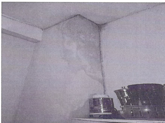
FOTO 03 : PAREDE DA COZINHA
