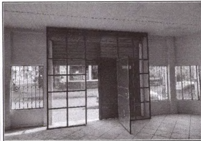
Foto 04: Porta em aço esterira de enrolar com grade interna de ferro com vidro.
