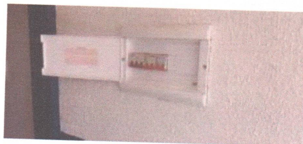
IMAGEM 5 QGD 1 PONTO INSTALAR DPS
