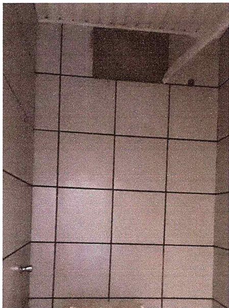
Legenda: Banheiro usado como depósito, sem ventilação.
