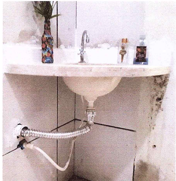
Legenda: Banheiro apresenta mau cheiro.
