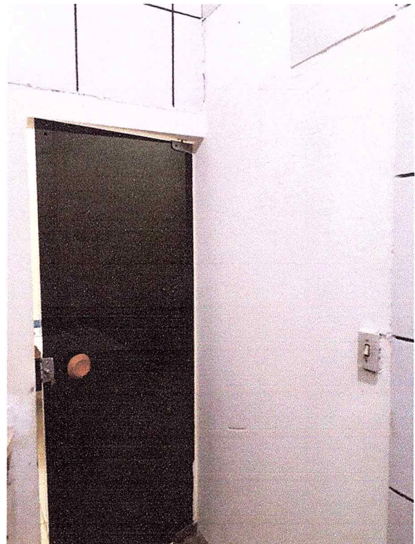
Legenda: Banheiro com falta de revestimento cerâmico.
