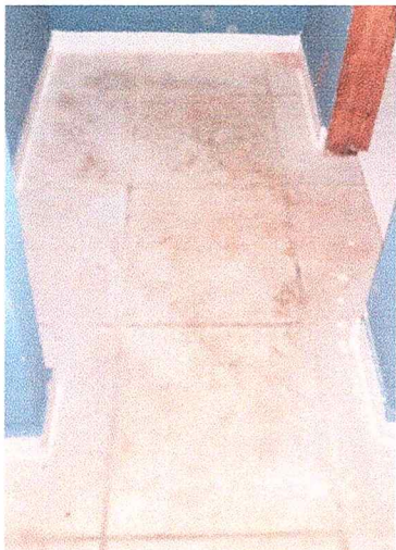
Legenda: Acesso aos banheiros de uso comum, piso com muitas manchas.
