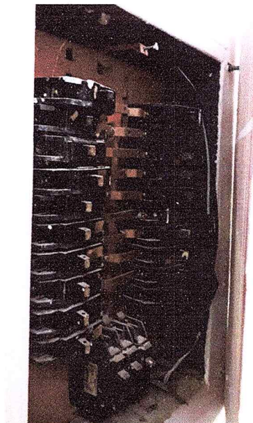
Legenda: Caixa de disjuntores inativo.
