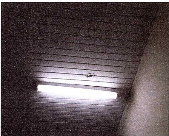
Legenda: Pequena avaria no forro de PVC
