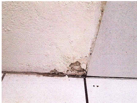
Legenda: Presença de infiltração advinda do solo.
