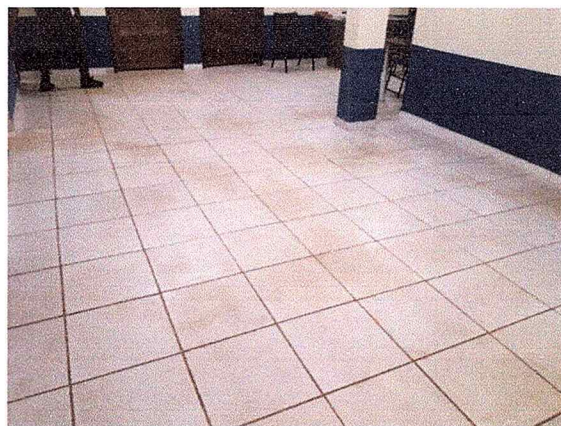
Legenda: Piso manchado, em toda a edificação.
