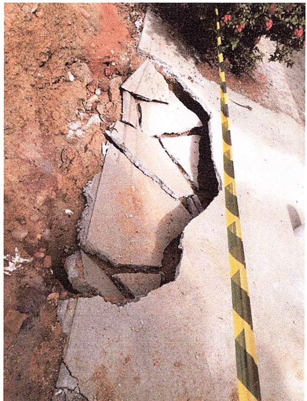
Legenda: Tampa da fossa bastante deteriorada, colocando em risco os usuários.
