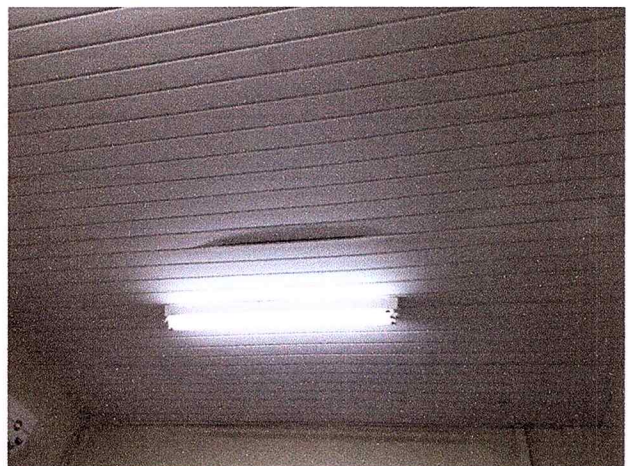
Legenda: Pequena avaria no forro de PVC
