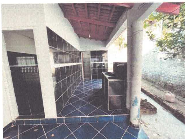
Imagem 16 – Área de Serviço
