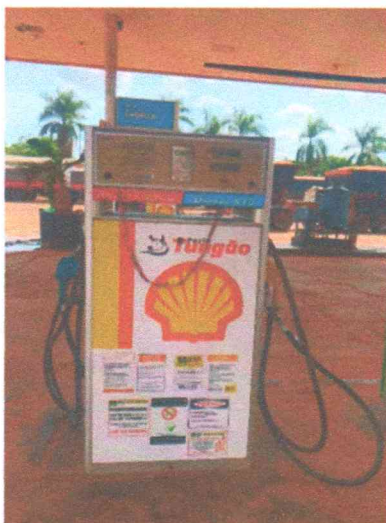
Figura 7 Bomba Diesel s-10
