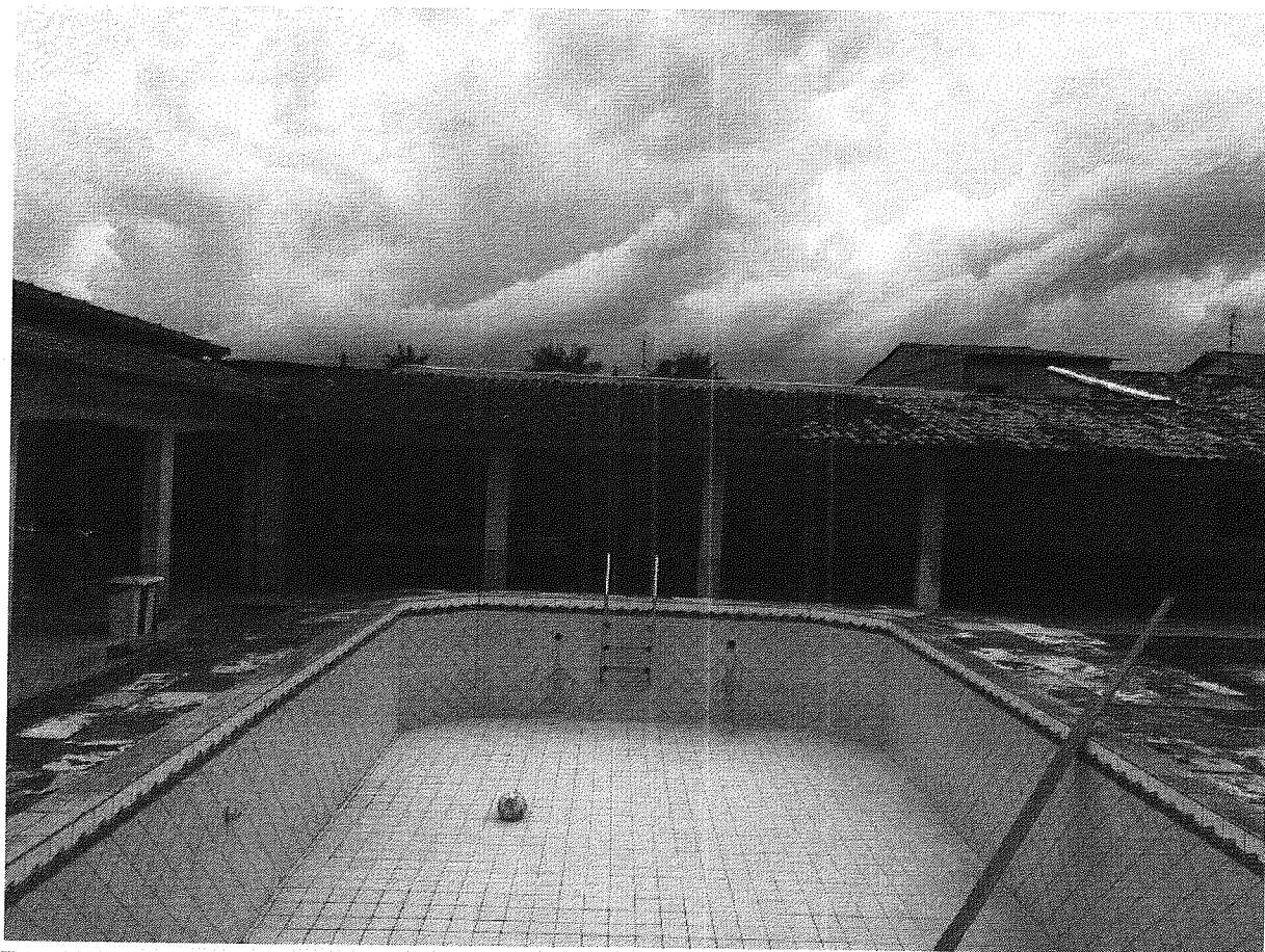
Foto 03 Infiltrações de cumeeira retiradas
