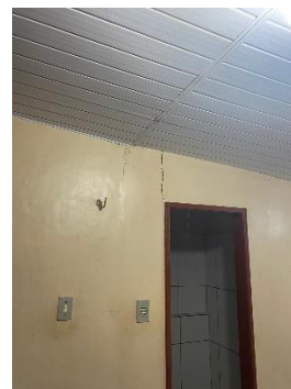
Imagem 08: Fissura existente em cima da porta de um dos banheiros.
