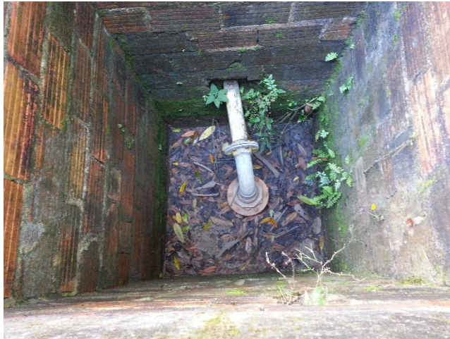
Tubulação de sucção em um poço raso
