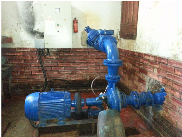
Elevatória do Parque Ambiental, 01 conjunto MB sem reserva
