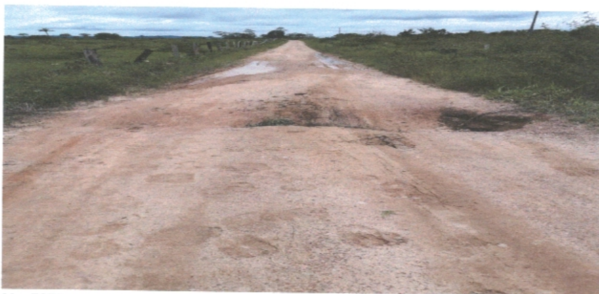
06 – ESTRADA VICINAL CAMPINHO / Km. 45 / FOTO em 02/04/2018
