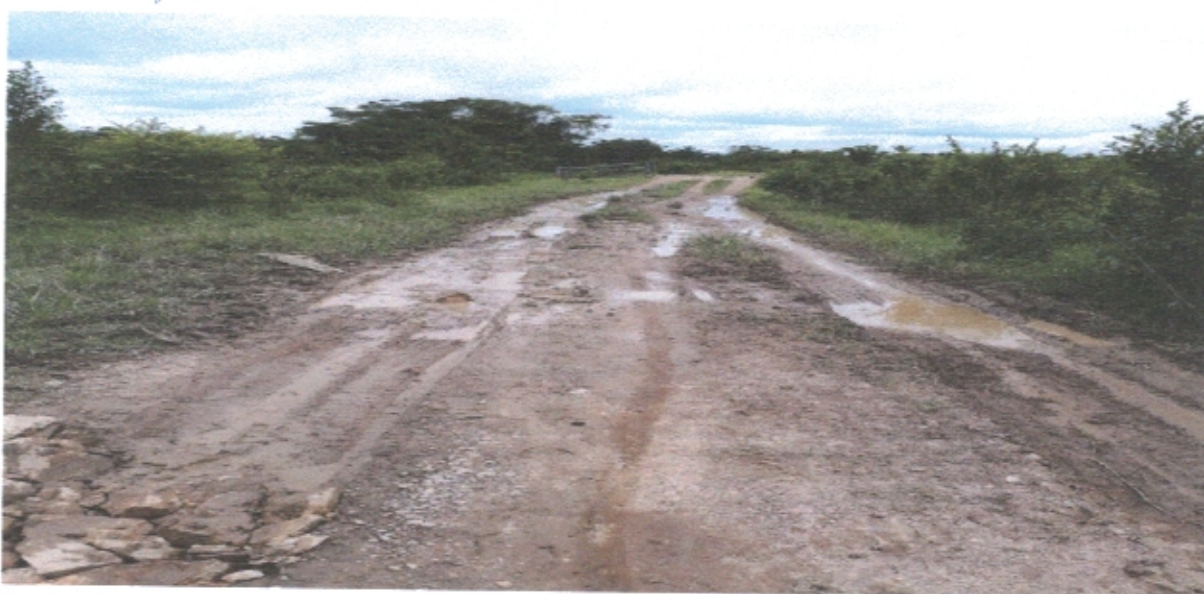
05 – ESTRADA VICINAL CAMPINHO / Km. 32 / FOTO em 02/04/2018
