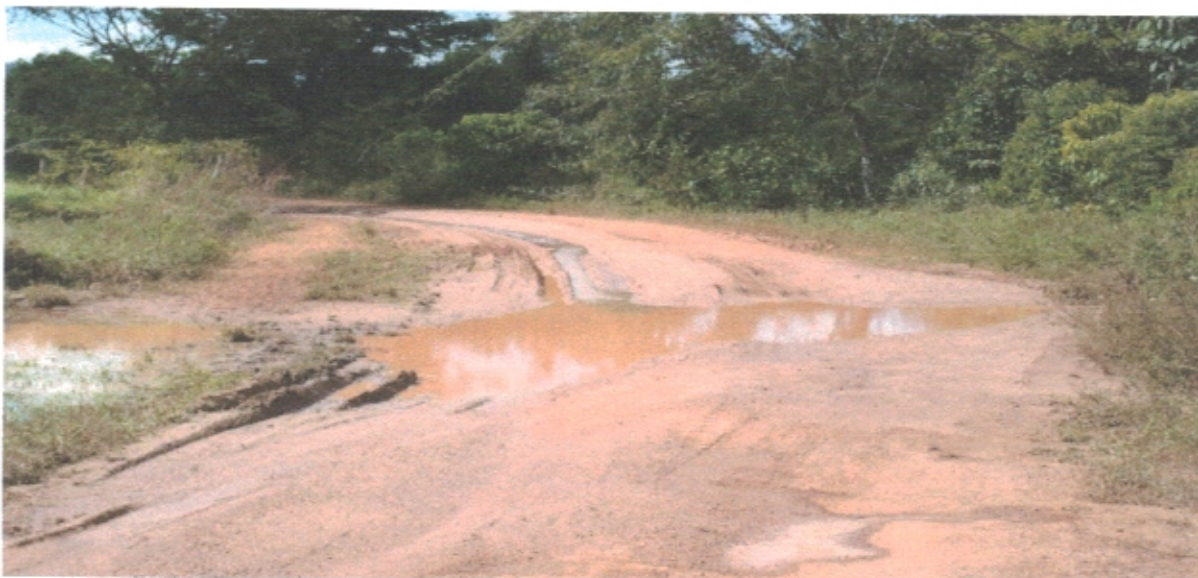
07 – ESTRADA VICINAL CAMPINHO / Km. 53 / FOTO em 02/04/2018
