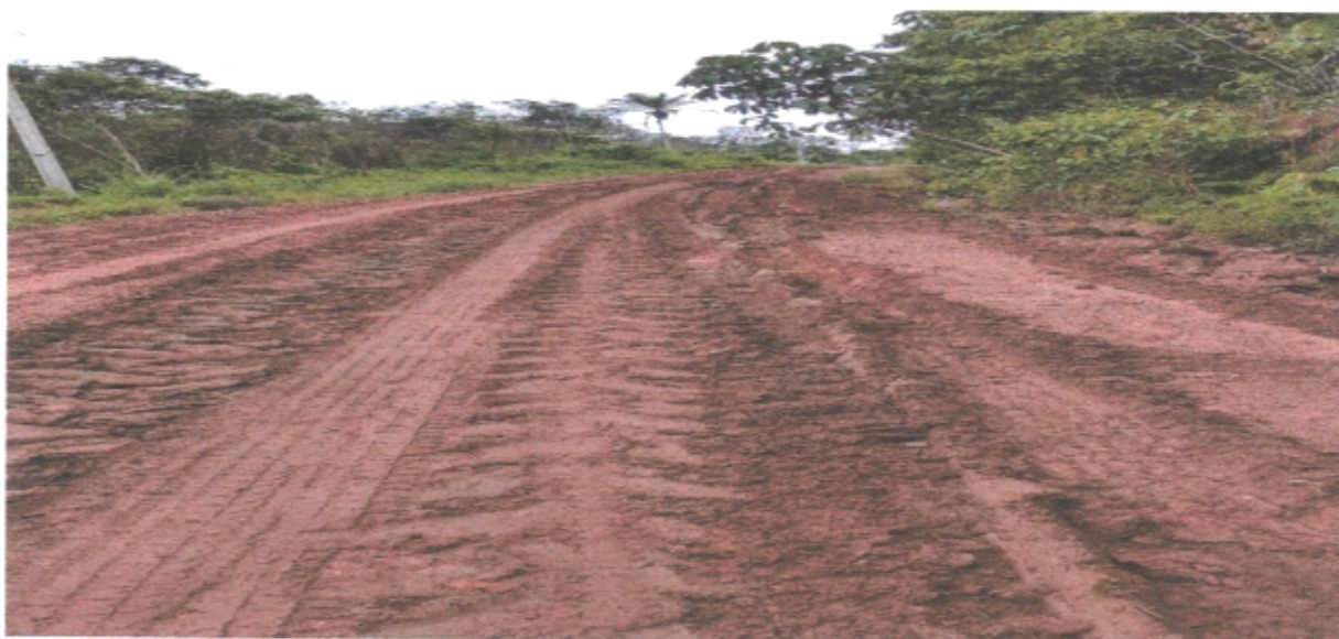
03 – ESTRADA VICINAL CAMPINHO / Km. 16 / FOTO em 02/04/2018
