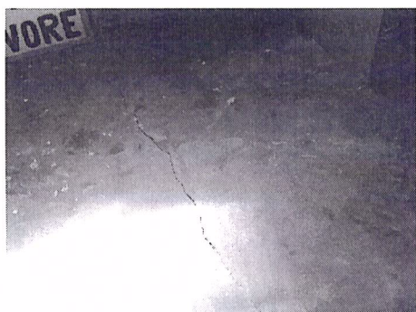
FOTO 01- RACHADURA DO PISO
