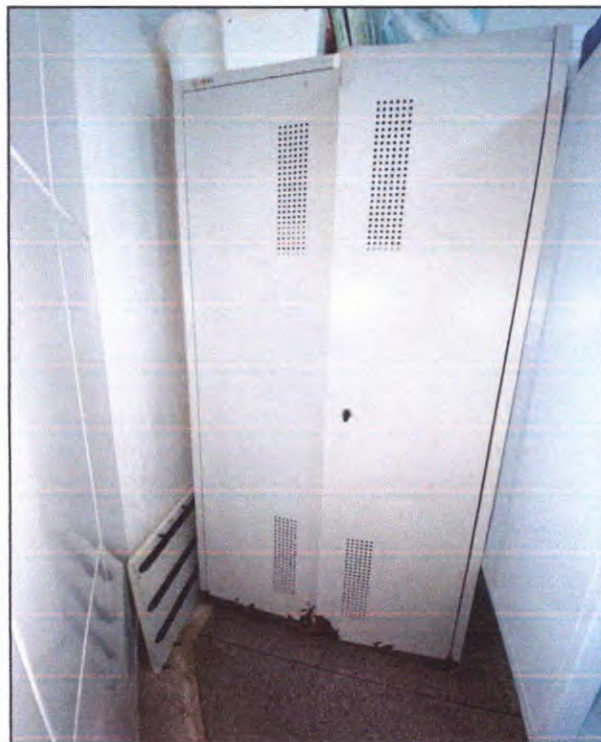
Figura 2. Armário de aço enferrujado – UBS Altamira.
