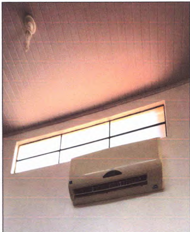
Figura 1. Central de ar não funciona, precisa ser substituída – UBS Casas Populares.
