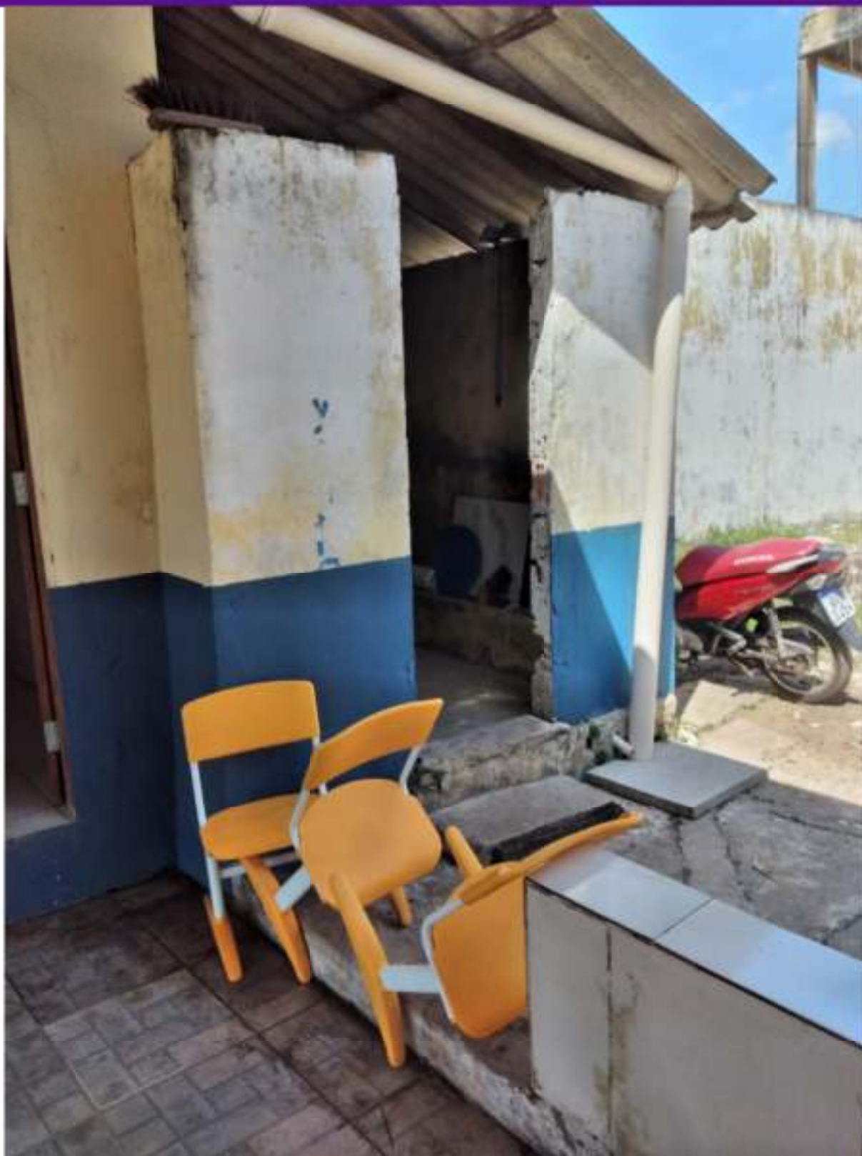
FOTO 08 – FECHAMENTO DE MURETA QUE DA ACESSO PARA ÁREA LIVRE COM RISCO DE ACIDENTE
