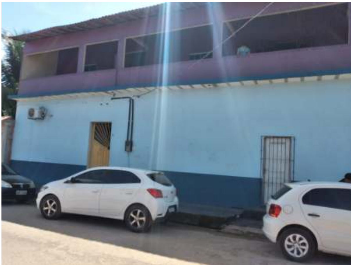
FOTO 01 – FACHADA DA ESCOLA , FALTANDO SER INSTALADA A PLACA DE IDENTIFICAÇÃO E RAMPA DE ACESSO PARA PCD
