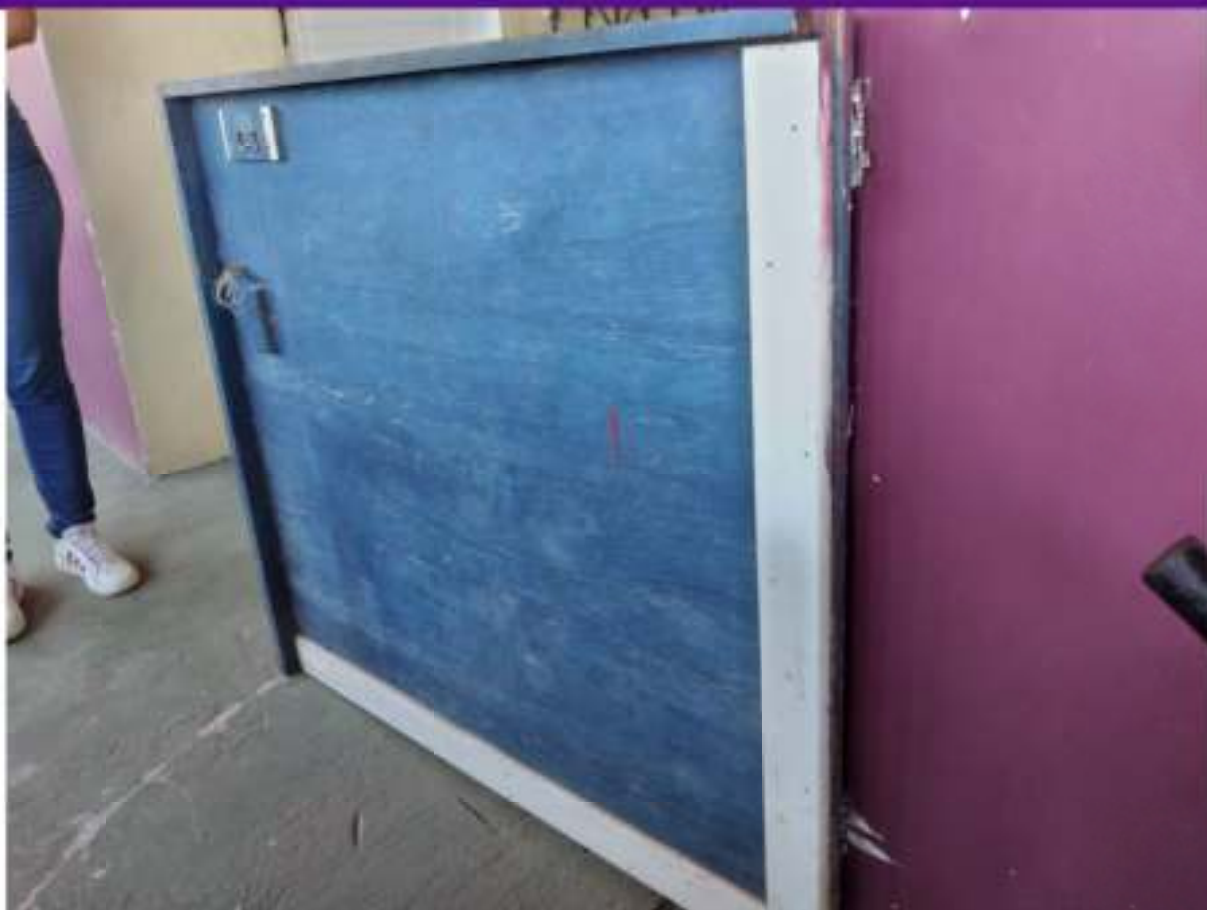
FOTO 10 – CONERTO DA PORTA DE PROTEÇÃO EM COMPENSADO QUE DAR ACESSO PARA A ESCADA
