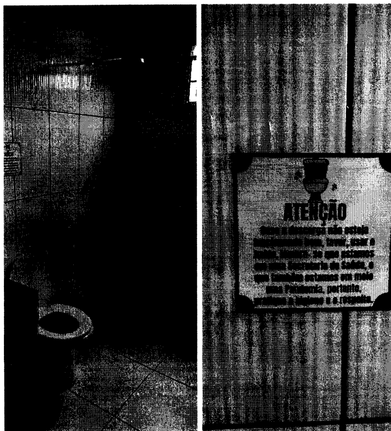
Fotos 08 e 09: Banheiro social com problemas de entupimento.
