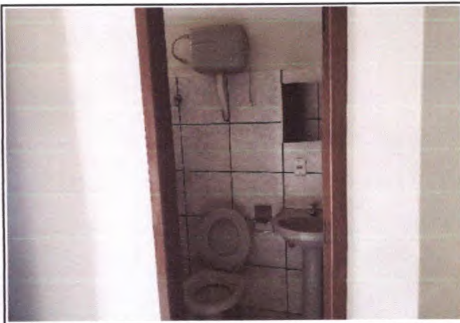
Foto 22: Vaso sanitário e pia em louça e torneira em inox.
