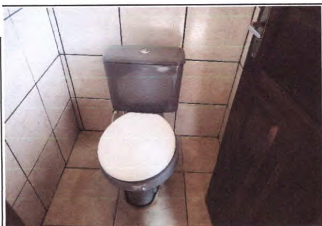
Foto 21: Vaso sanitário com caixa de descarga acoplada.
