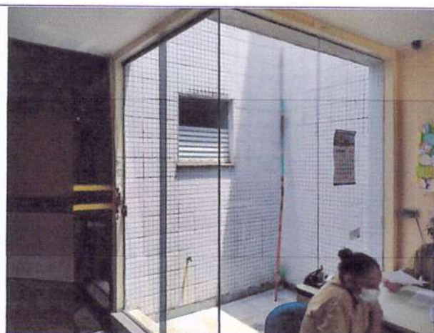
Foto 07: Área de ventilação
