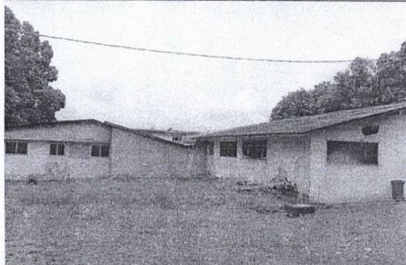
Foto 10: área externa faltando acabamento.
