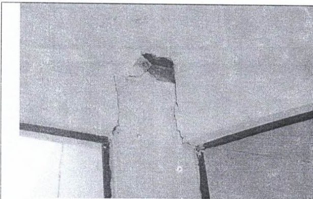
Foto 01: Descolamento do gesso, devido à infiltração.
