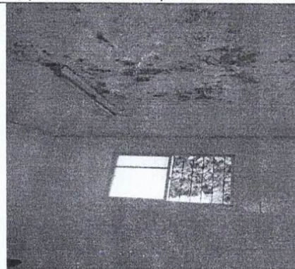
Foto 04: Infiltração na laje de ferro.
