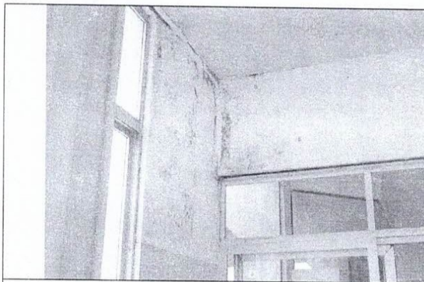
Foto 01: Infiltração entre parede e forro.
