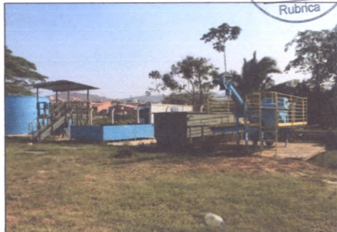
Foto 02 - Filtros, caixa de gordura e desarenador
