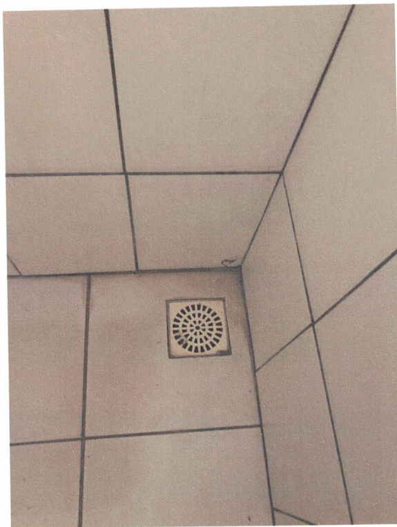
Imagem 35: ralo do banheiro da sala de atendimento.
