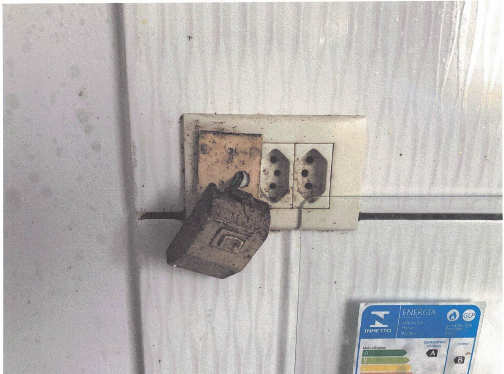
Imagem 85: tomada e interruptor da cozinha.
