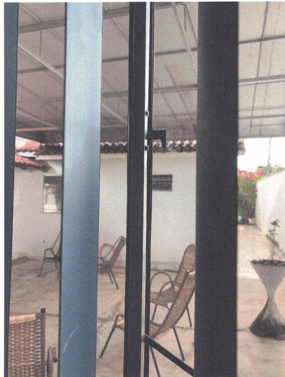
Imagens 82: fechadura da janela da farmácia com problemas.
