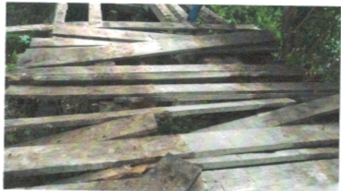
Ponte 15,00m – Vista do assoalho deteriorado
