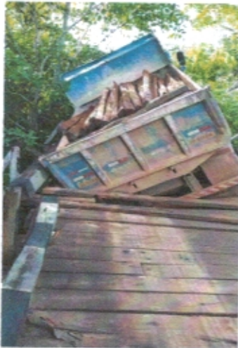
Ponte 15,00m – Vista do assoalho que cedeu com o caminhão
