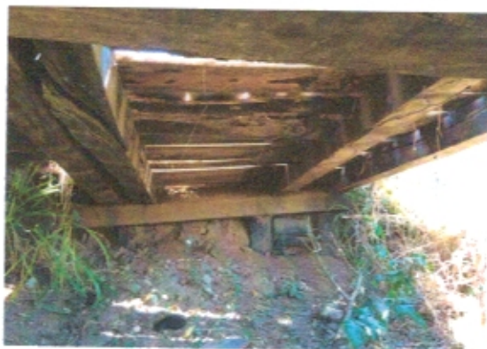
Ponte 12,00m – Vista do tabuleiro quebrado
