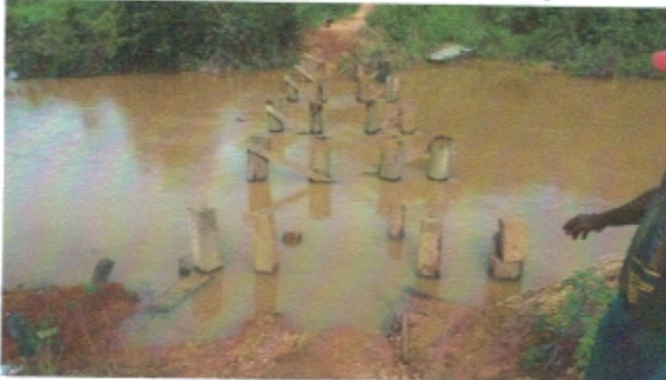
Ponte 35,00m – Vista das estacas que restaram
