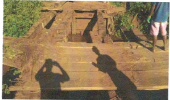
Ponte 10,00m – Vista do assoalho quebrado
