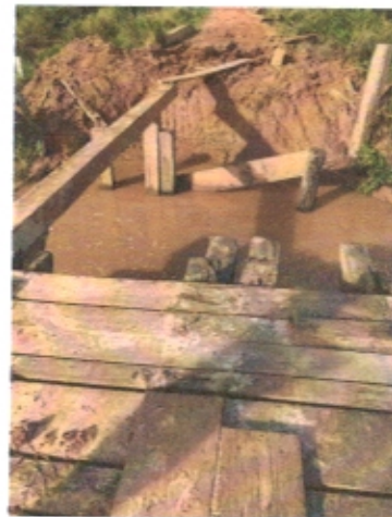
Ponte 10,00m – Vista do que restou com a enchente
