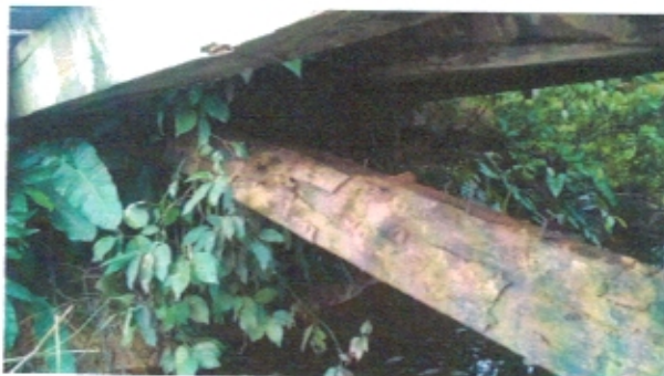
Ponte 6,00m – Vista da longarina caída
