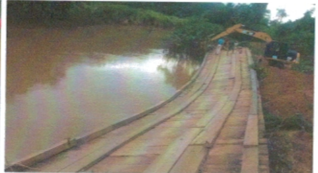
Ponte 35,00m – Vista do assoalho que rodou com a enchente
