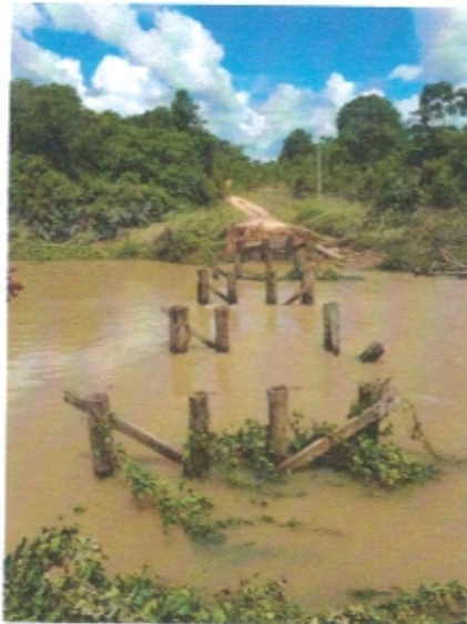
Ponte 25,00m – Vista das estacas que restaram
