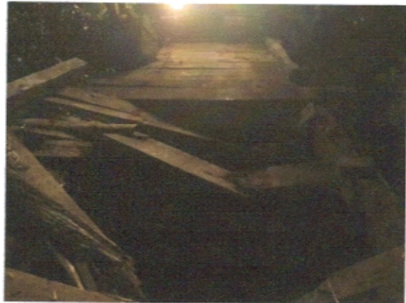
Ponte 15,00m – Vista do assoalho quebrado
