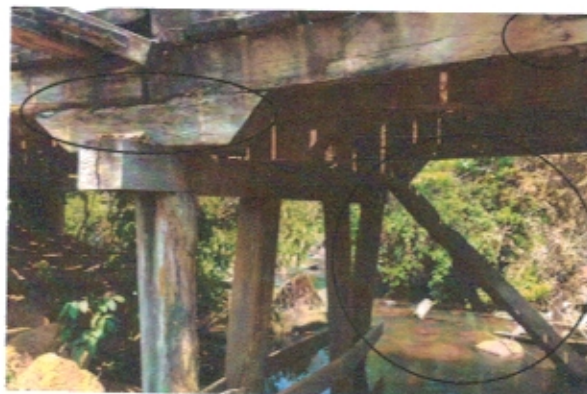
Ponte 12,00m – Vista do balancim deteriorado
