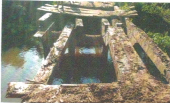
Ponte 10,00m – Vista do assoalho quebrado
