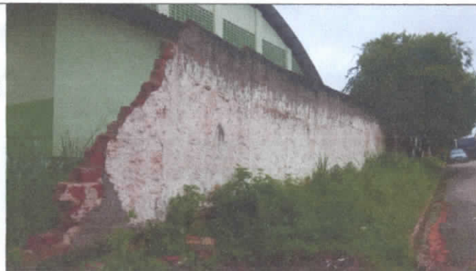
Etapa que precisava ser demolida imediatamente
