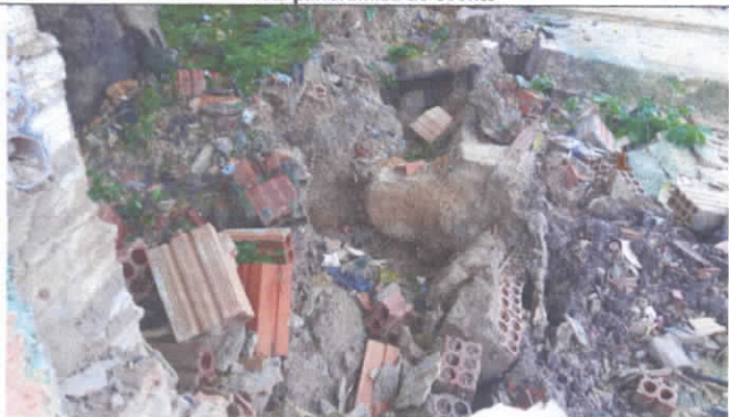
Detalhe do pilar que aparentava não ter mais que 30cm de fundura
