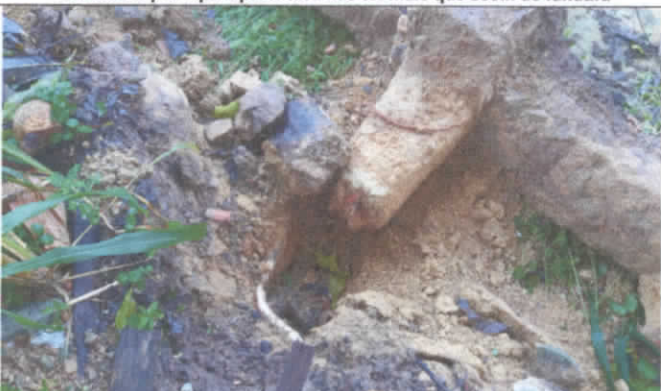
Aspecto da raiz no entorno de um dos pilares
