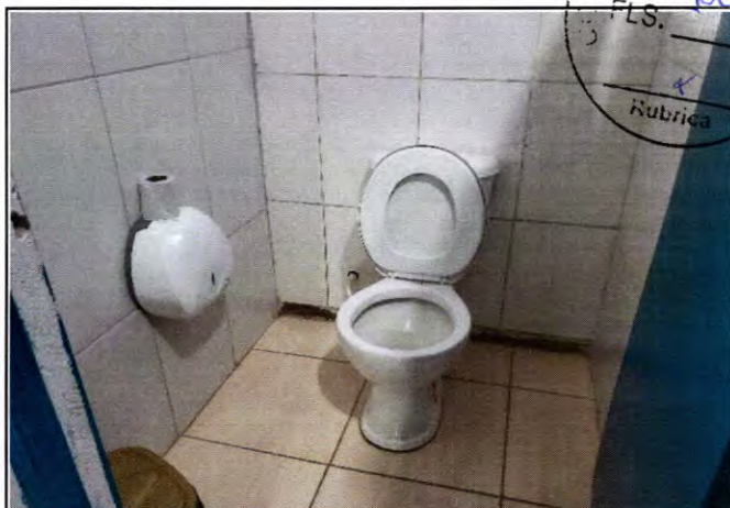
Foto 08: Vasos sanitários com caixa acoplada.
